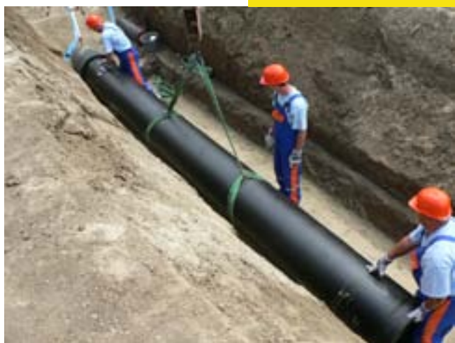
A sima csővég betolása a TYTON tokba – a csőszál még felfüggesztett állapotban van
